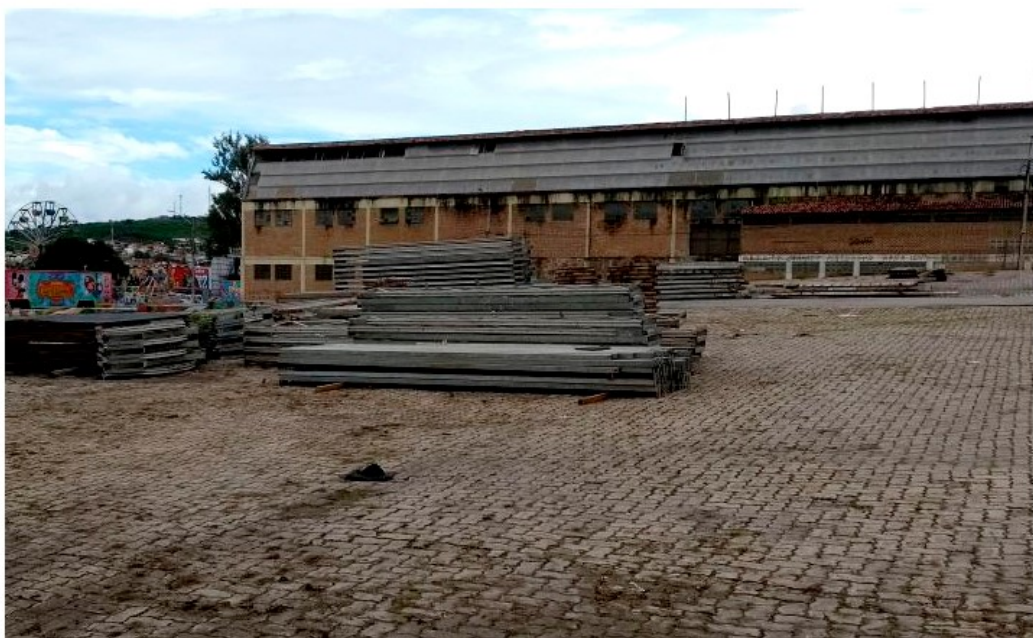
Os trabalhos tinham sido interditados no dia 14 de maio. (Imagem: Dido Montenegro/Rádio Cultura do Nordeste)
